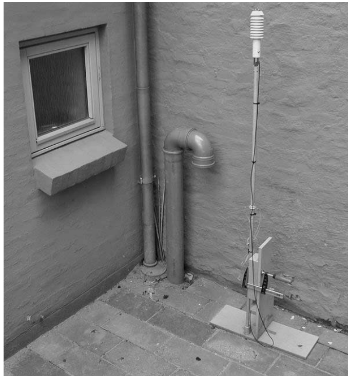
Figur 9. Måling af udendørs temperatur i ejendommens baggård. Bemærk svane-halsen, der er koblet til det kapillarbrydende lag under terrændækket.
